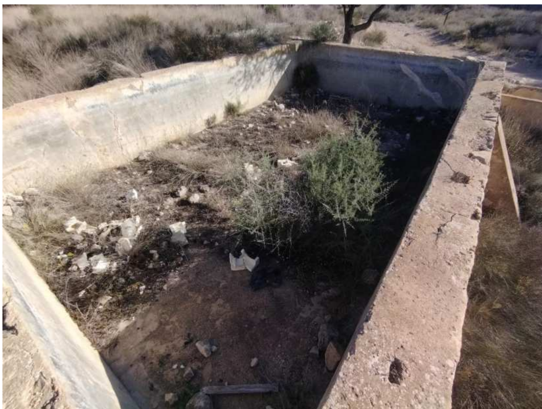
Balsa abastecida por el pozo
