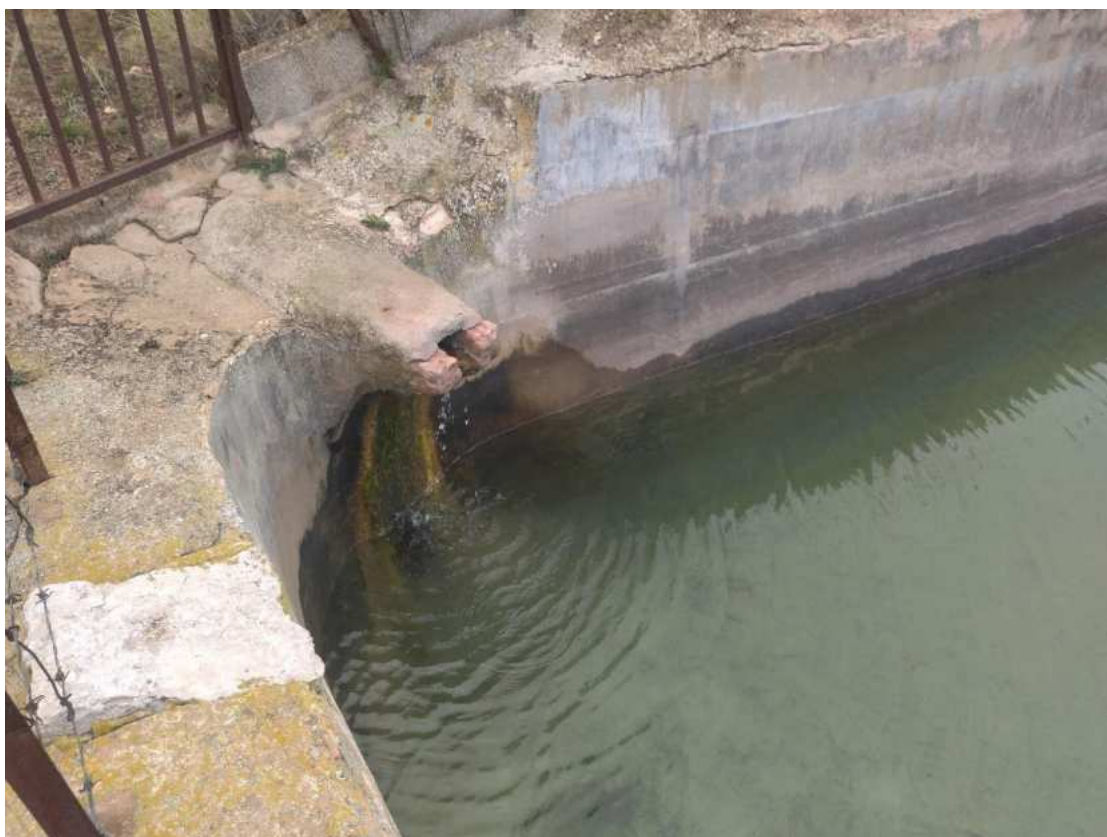
Canal de suministro de la balsa
